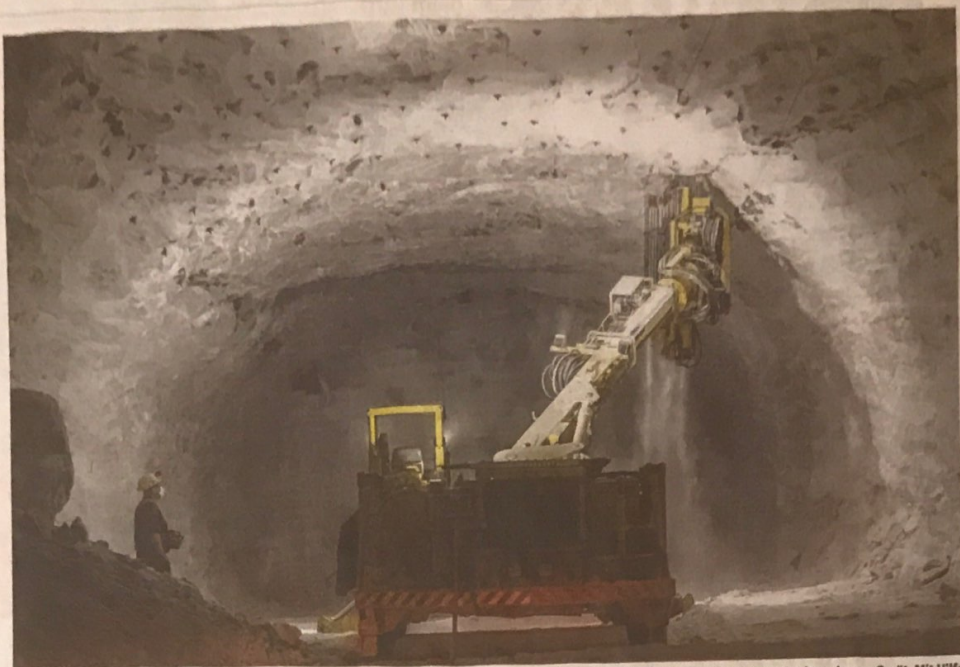
Mensch und Maschine. Die Wirklichkeit einer irgendwie unwirklichen Arbeitswelt. Der Kumpel ist eine Randfigur, den Knochenjob macht das schwere Gerät. Mit Hilfe des ferngesteuerten Ankerbohrwagens werden unzählige Sicherungen in die Decke gesetzt, um die ausgehöhlte Kammer stabil zu halten. FOTO: MARC ALBERS
